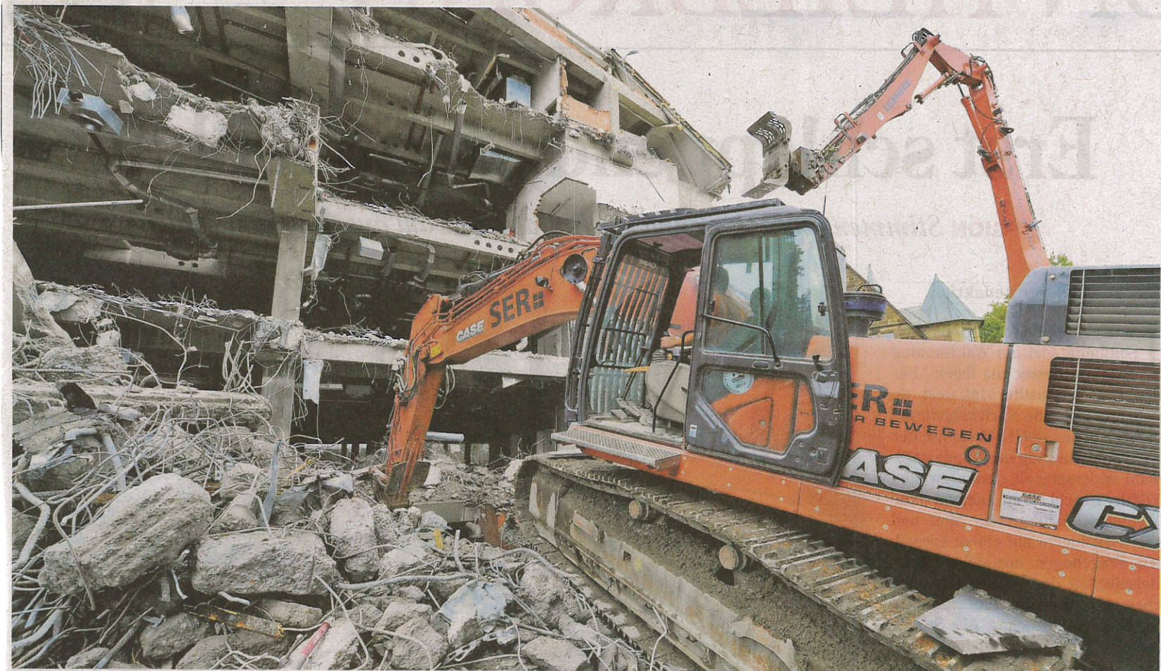
Als ob ein Sprengsatz explodiert wäre: Das C&A-Gebäude wird mit Spezialgerät Meter um Meter voraussichtlich bis Ende November abgerissen.
